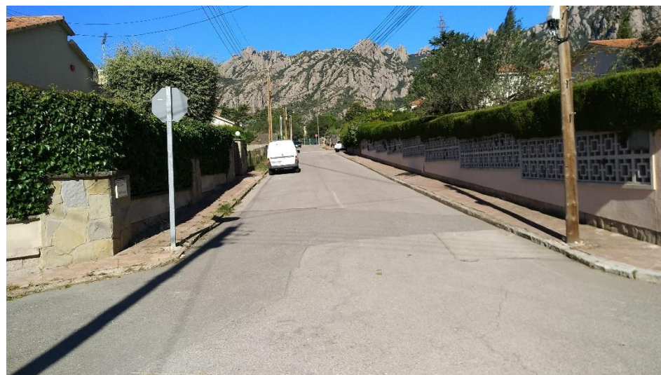
Carrer Menàrguens (deteriorament mitjà)
