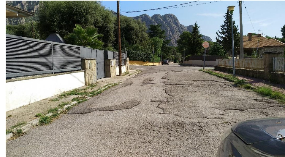
Carrer La Sentiu (molt deteriorada)
