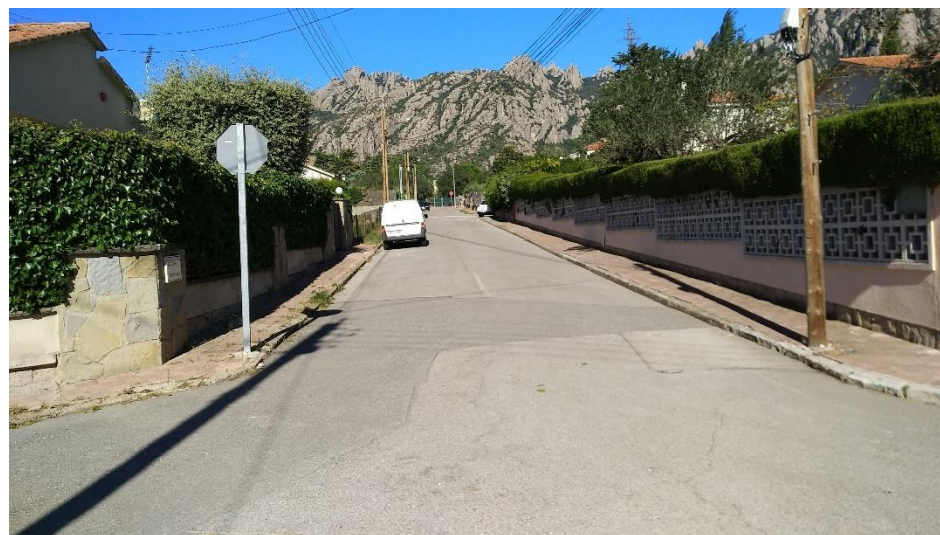
Carrer Menàrguens (deteriorament mitjà)
