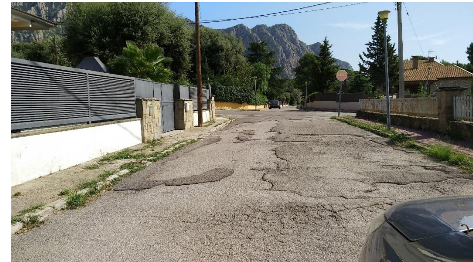
Carrer La Sentiu (molt deteriorada)
